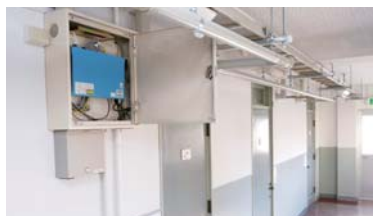
研究棟の廊下に設置された APRESIA。FAN レスの静音設計により、教育・研究の妨げにならず、キャンパスネットワークの安定稼働を実現している。
